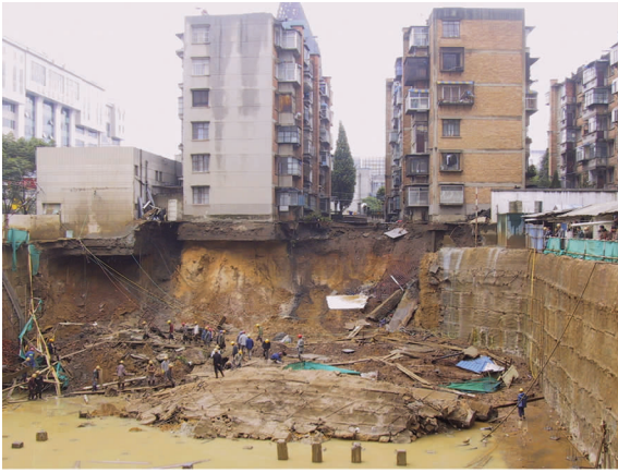
图7 某基坑边坡失稳事故
