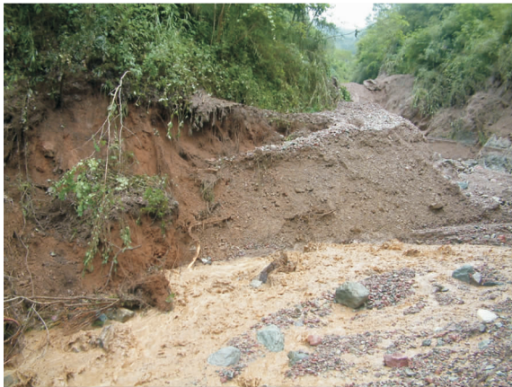
图 7 新堰沟中尚存的松散堆积物为孙家沟泥石流提供物源
