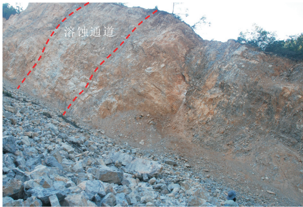
图1 滑坡西侧壁发育的溶蚀通道
